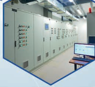
Elektrik ve Otomasyon Merkezi
